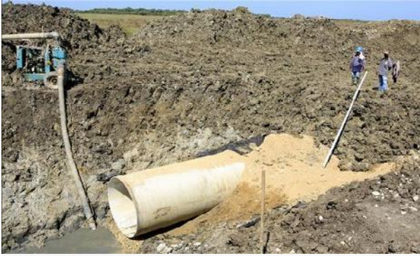
Figura 2. Tubo emisario para la captación o vertido de agua de alimentación.
