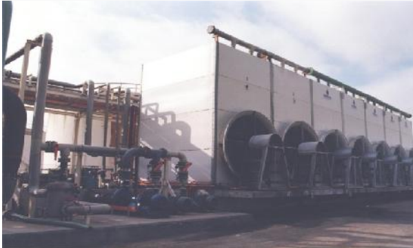
Figura 2. Torres tiro forzado.
