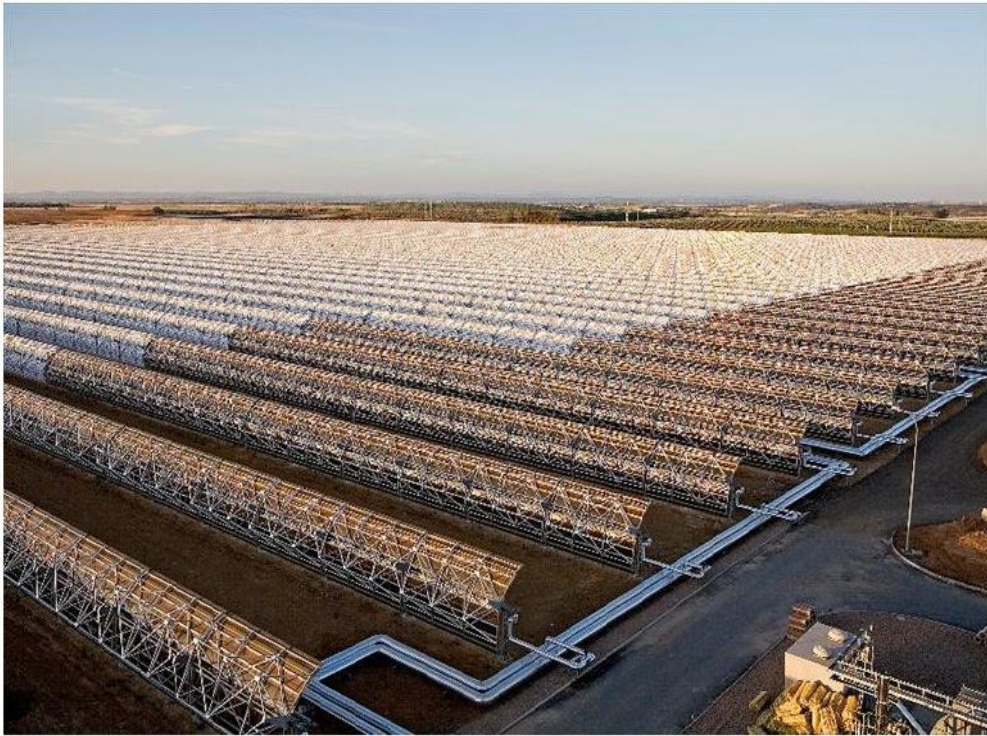
Figura 2. Campo de colectores.
