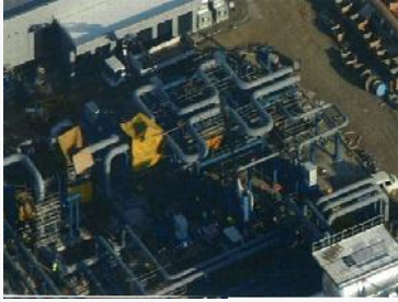
Figura 3. Sistema de bombeo principal
